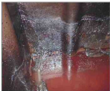
Verschmutzte Tanks stören den Heizbetrieb →
